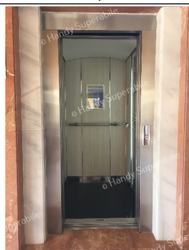
Ascensore blocco A
